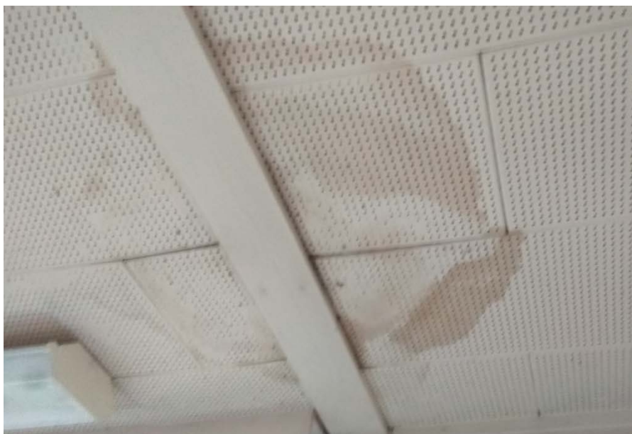
Kuva 18-Käyttämättömän liiketilan katon kosteusvaurio
