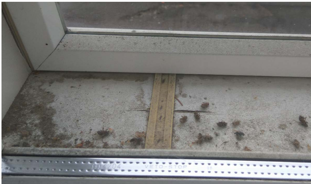
Kuva 10- Ikkunat eivät ole tiiviitä, ikkunoiden välissä likaa ja karpäsiä.
