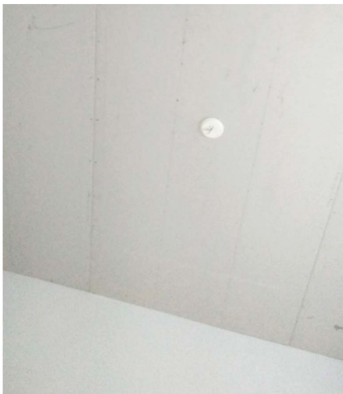
Kuva 1610-Katto, josta pinnoite tippunut
