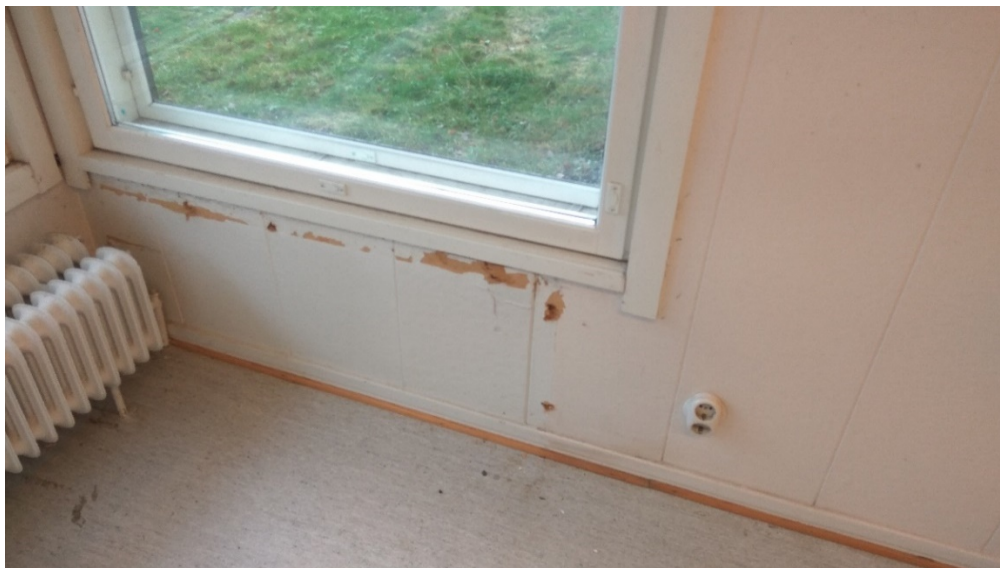
Kuva 11-Käyttämättömän liiketilan pintavaurioita
