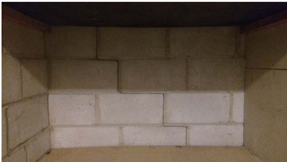
Kuva 20-Vaurio käyttämättömän liiketilan kellarin seinässä
