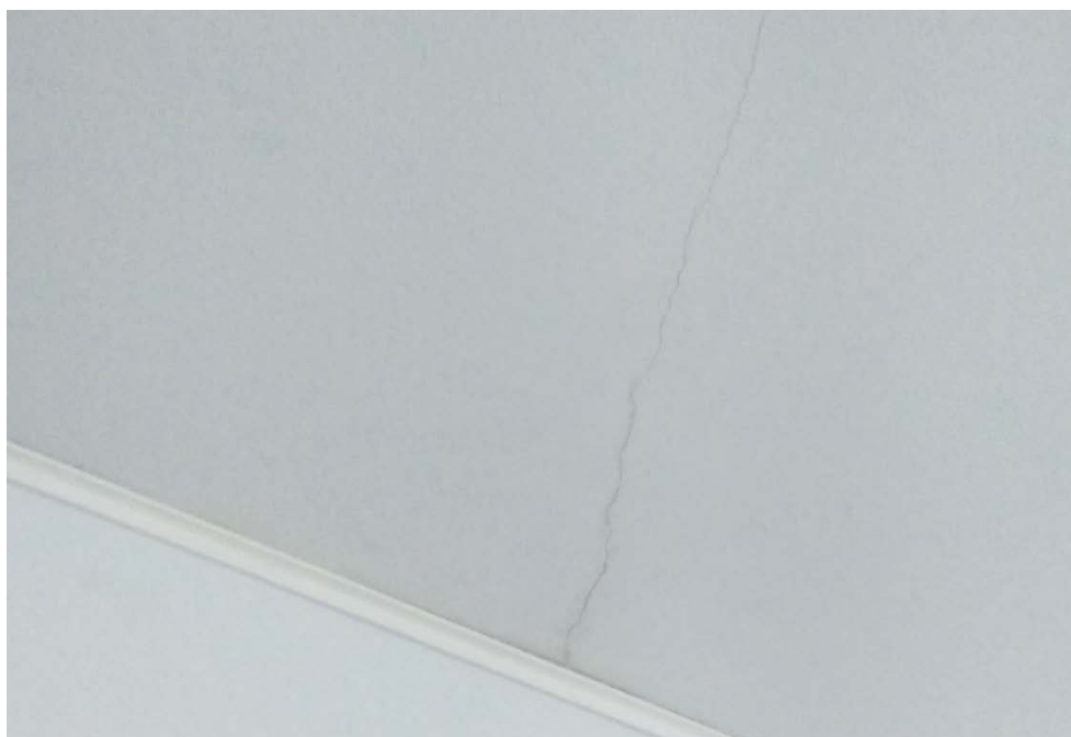
Kuva 17-Käytössä olevan liiketilan katon halkeama
