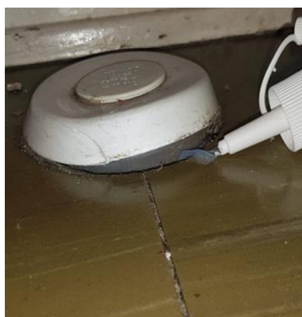
Kuva 43. Tulpatun viemärin läpiviennin kohdalta todettiin ilmayhteys eristetilaan.
