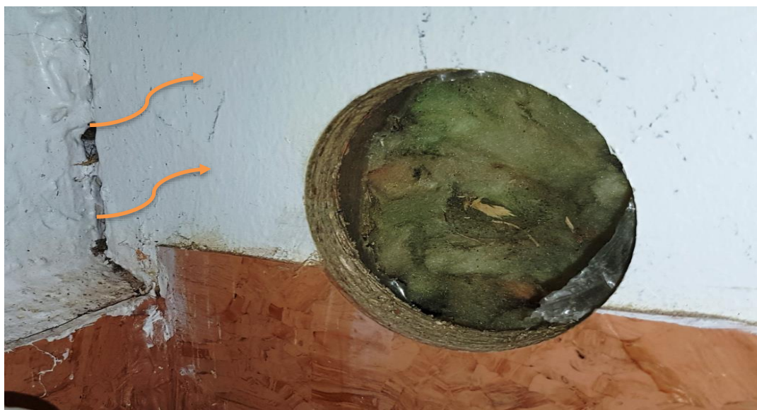
Kuva 32. Vanhassa ulkoseinärakenteessa todettiin aktiivista mikrobikasvustoa. Rakenteesta on suora ilmayhteys sisäilmaan.
