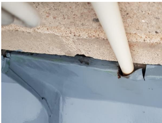
Kuva 8. Katon läpiviennin kohdalta puuttuu tiivistemassa.
