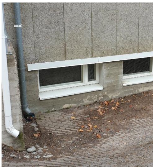
Kuva 2. Pihamaa viettää paikoin rakennusta päin.
