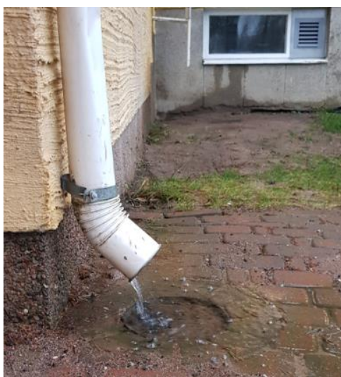
Kuva 4. Hulevesi ei kulkeudu hulevesiputkistoon.
