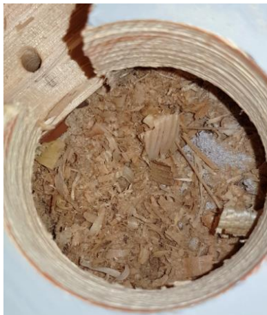
Kuva 37. Välipohjan eristeenä on purueristettyä. Eristeen ja lattialaudan välissä ei ole ilmansulkua.
