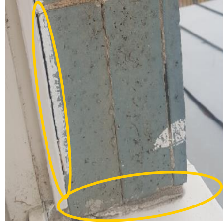
Kuva 24. Tiiveyspuutteiden vuoksi rakenteeseen voi päästä vettä.
