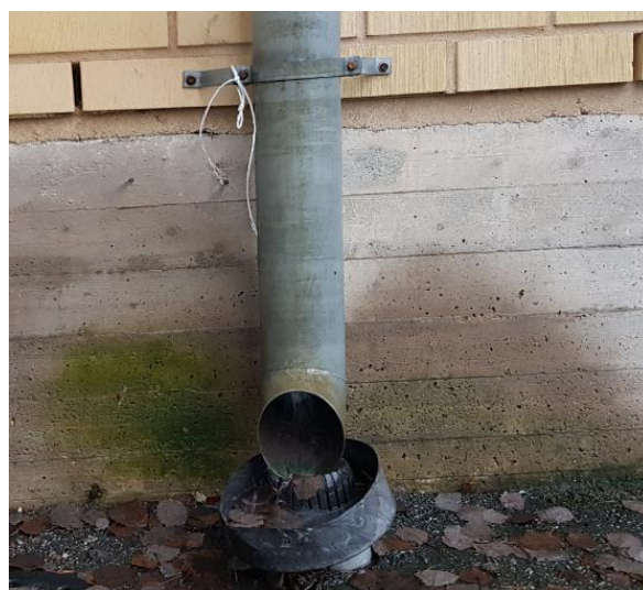
Kuva 5. Rännikaivo on vääntynyt paikaltaan.
