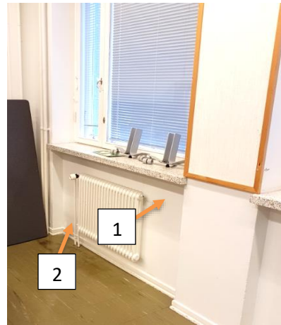
Kuva 15. Ensimmäisessä kerroksessa seinän alaosan lämmöneristeinä on lastuvillalevyä mineraalivillan sijasta. Kohdassa 1 lämmöneriste on mineraalivillaa ja kohdassa 2 lastuvillalevyä.
