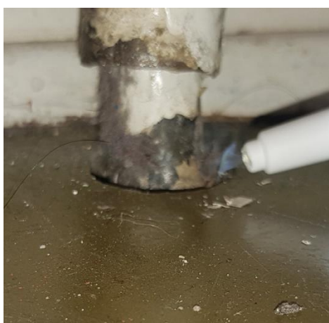
Kuva 42. Patteriputken läpivientien kohdat eivät ole tiiviitä.
