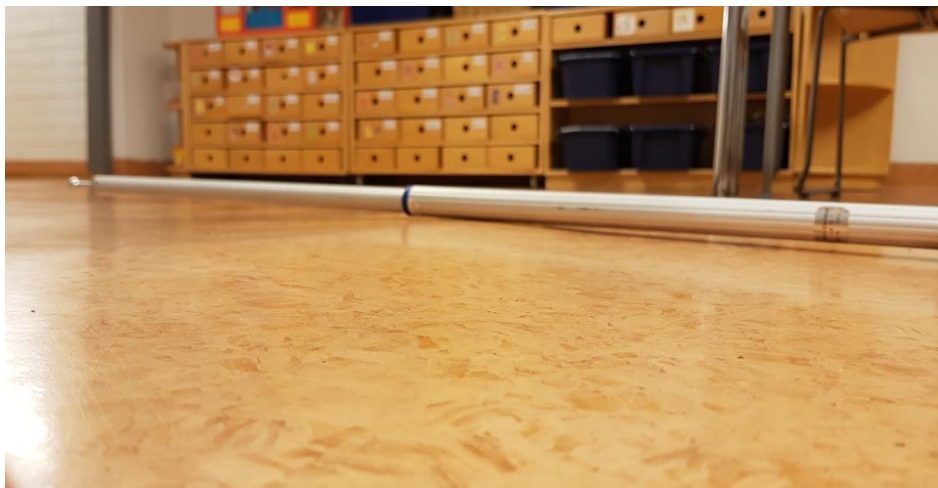
Kuva 27. Lattialaatta on pahasti koholla.
