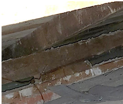
Kuva 10. Yläpohjan tuuletus räystäältä on puutteellista.
