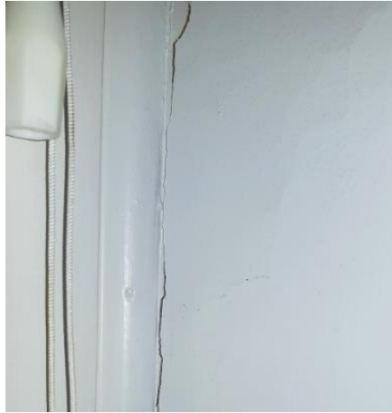
Kuva 25. Ikkunalistan rajalla oleva maalipinta on revennyt.
