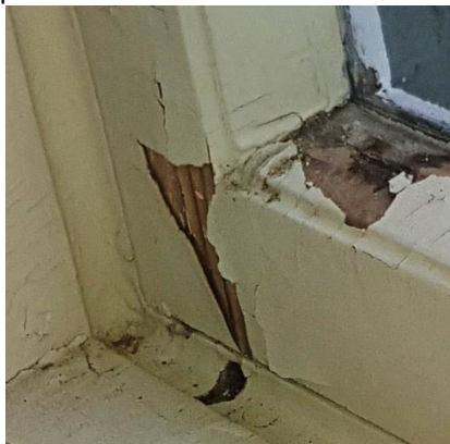
Kuva 21. Ikkunan puitteissa on paikallisia kosteus- / maalivaurioita.
