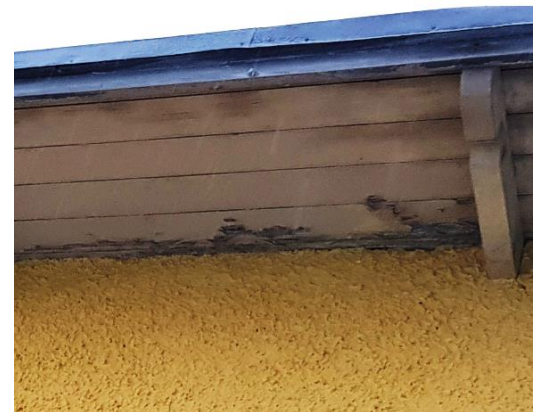
Kuva 9. Räystään aluslaudoituksessa oli monin paikoin kosteusjälkeä.
