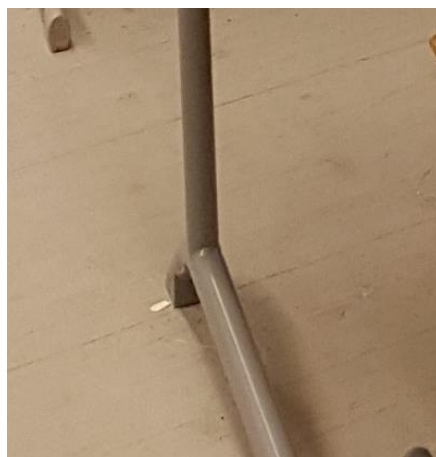
Kuva 41. Ilmaa pääsee kulkeutumaan eristetilasta lattialautojen raoista sisäilmaan.
