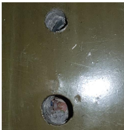
Kuva 40. Välipohjassa on paikkaamattomia reikiä.
