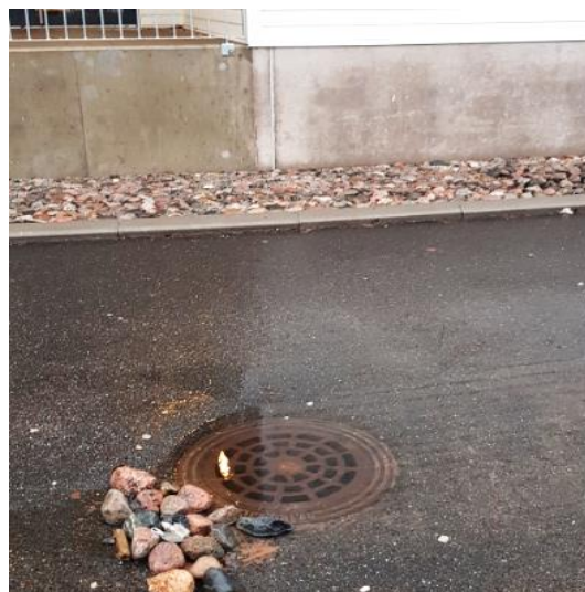
Kuva 3. Sadevesikaivo on tukossa.
