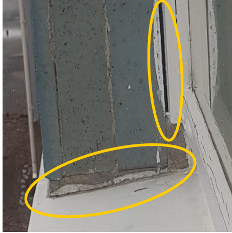
Kuva 23. Ikkunan vesipeltiä ei ole nostettu pilaria vasten. Ikkunankarmia ei ole tiivistetty klinkkerilaattaan. Tiiveyspuutteiden vuoksi rakenteeseen voi päästä vettä.
