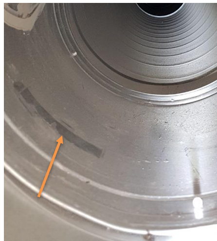
Kuva 47. Tuloilmakanavat olivat likaisia. Kuvassa näkyy kirkkaampana alueena geeliteipinäytteenottoa.
